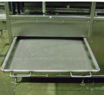
Grilles de récupération des particules au dessus des cuves
